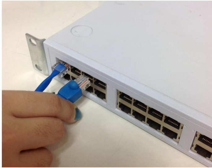
รูปที่ 8.6 การเชื่อมต่อสาย LAN ระหว่างเครื่องแอคเซสพอยต์กับเครื่องสวิตช์
