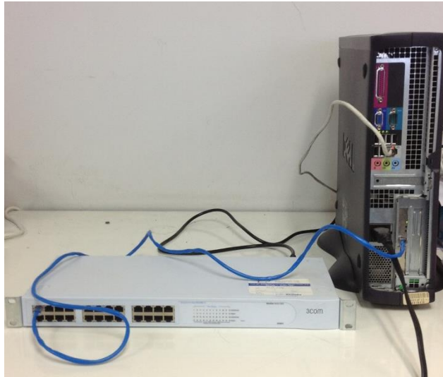
รูปที่ 8.4 การติดตั้งเครื่องแม่ข่ายกับระบบ
