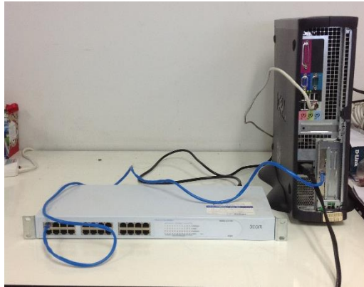
รูปที่ 8.2 การติดตั้งเครื่องแม่ข่ายกับระบบ
